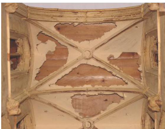
Fig. 18. Pérdidas de soporte de las bóvedas
